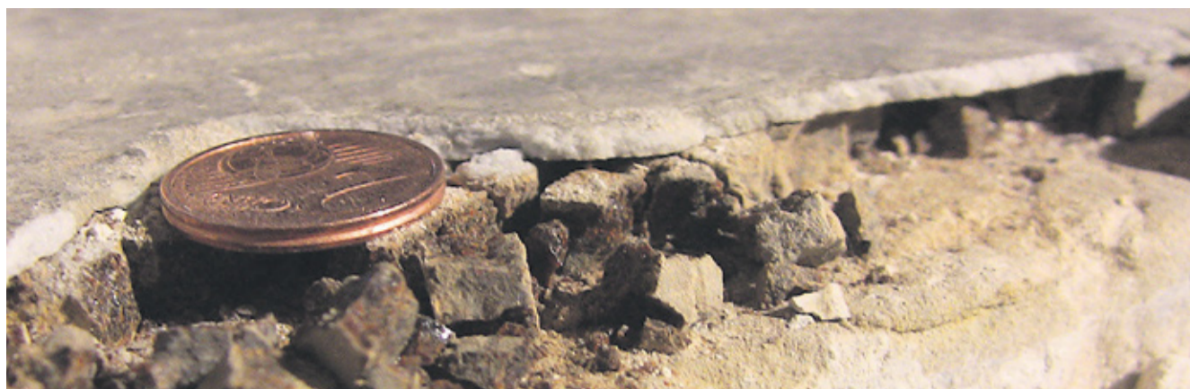
Der Marmorbelag ist so dünn wie eine Münze. Detailaufnahme des geöffneten Marmorfußbodens Foto: SPSP
