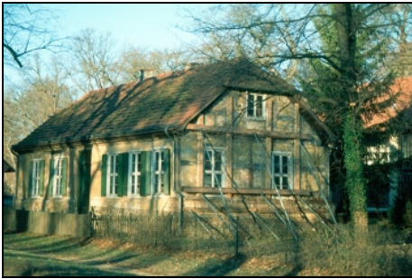
Rheinsberg, Schlosspark, Hofgärtnerhaus mit Notsicherung, 2004 Foto: SPSG, Detlef Fuchs
