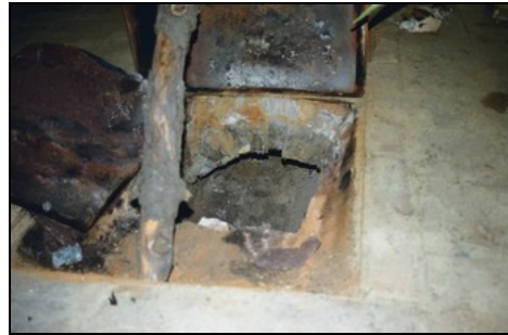
Potsdam, Neuer Garten, Orangerie, Kanalheizungsgang unter dem Fußboden Foto: SPSG, Hans-Heinrich-Gerlitz, März 1999
