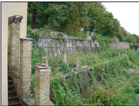
Potsdam, Winzerberg, Vorzustand der Terrassenanlage Foto: Roland Schulze, Baudenkmalpflege GmbH, 2007
